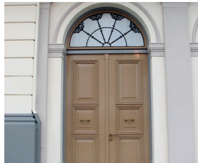
De kleurkeuze heeft veel tijd in beslag genomen. De gevel was oorspronkelijk veel geler, het houtwerk grijs. Het resultaat is verbluffend
